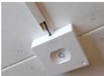
De kabelgoot te kort en aardedraad
